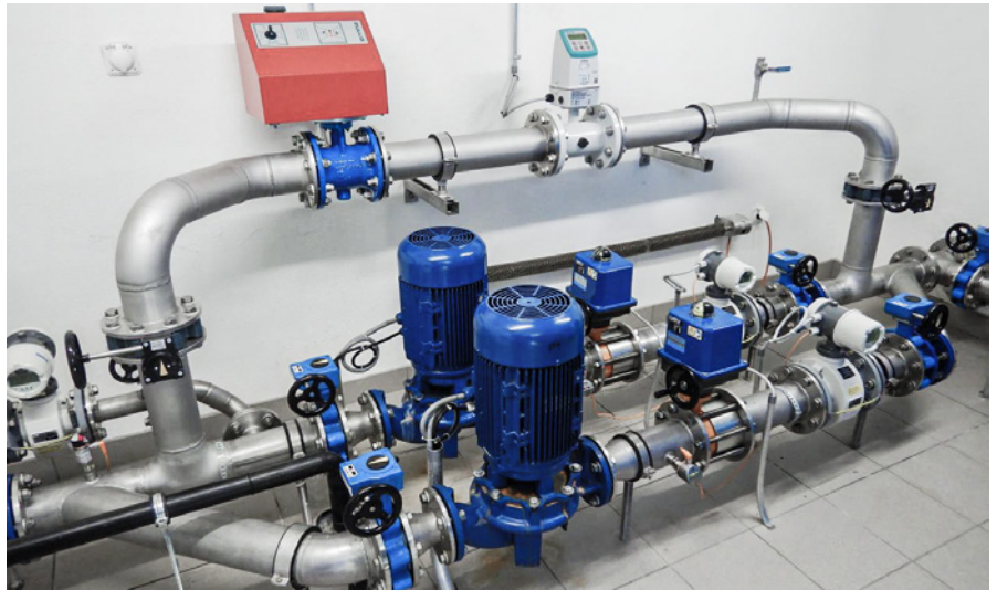
Pumpwerk Sursalens für die Einspeisung von Grundwasser ins Leitungsnetz
